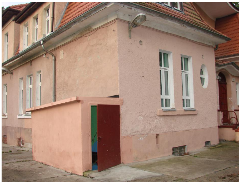
Fot. 1. Pierwsze, drugie, trzecie usprawnienie: docieplenie dachu, ściany i wymiana drzwi zejścia do piwnicy - dobudówki z l. 70. XX w.
